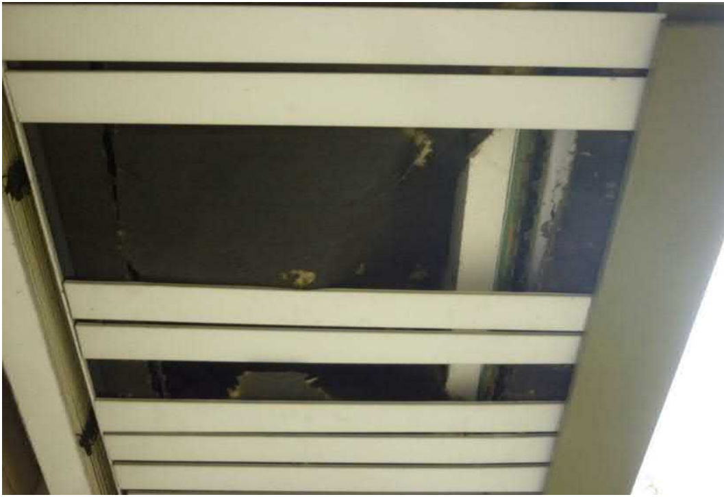
Abbildung 6: Exemplarisches Bild eines Zugangs hinter die Wandverkleidung am Hauptgebäude des Hauptschulgebäudes. Solche Zugänge werden gerne von Fledermäusen genutzt um zu Übertagen.
